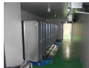
厨房チルド室写真
