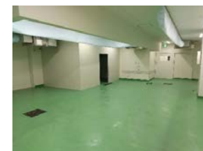
厨房盛付室写真
